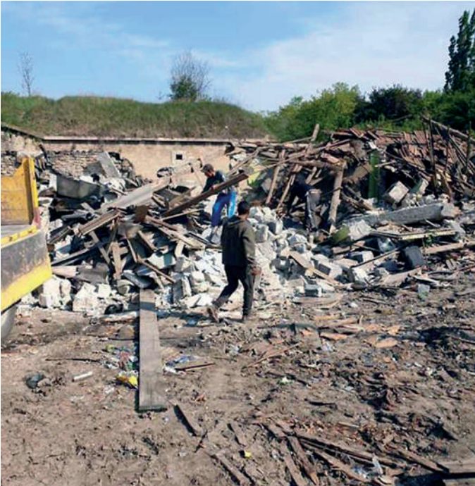
Közvetlenül a bontás után, ám a törmelékek elhordása előtt készült felvételen még láthatók az azbeszttartalmú hullámpala-darabok, amelyek pár nappal később lefóliázott raklapon bukkantak fel, ép állapotban. Csoda történt volna?
